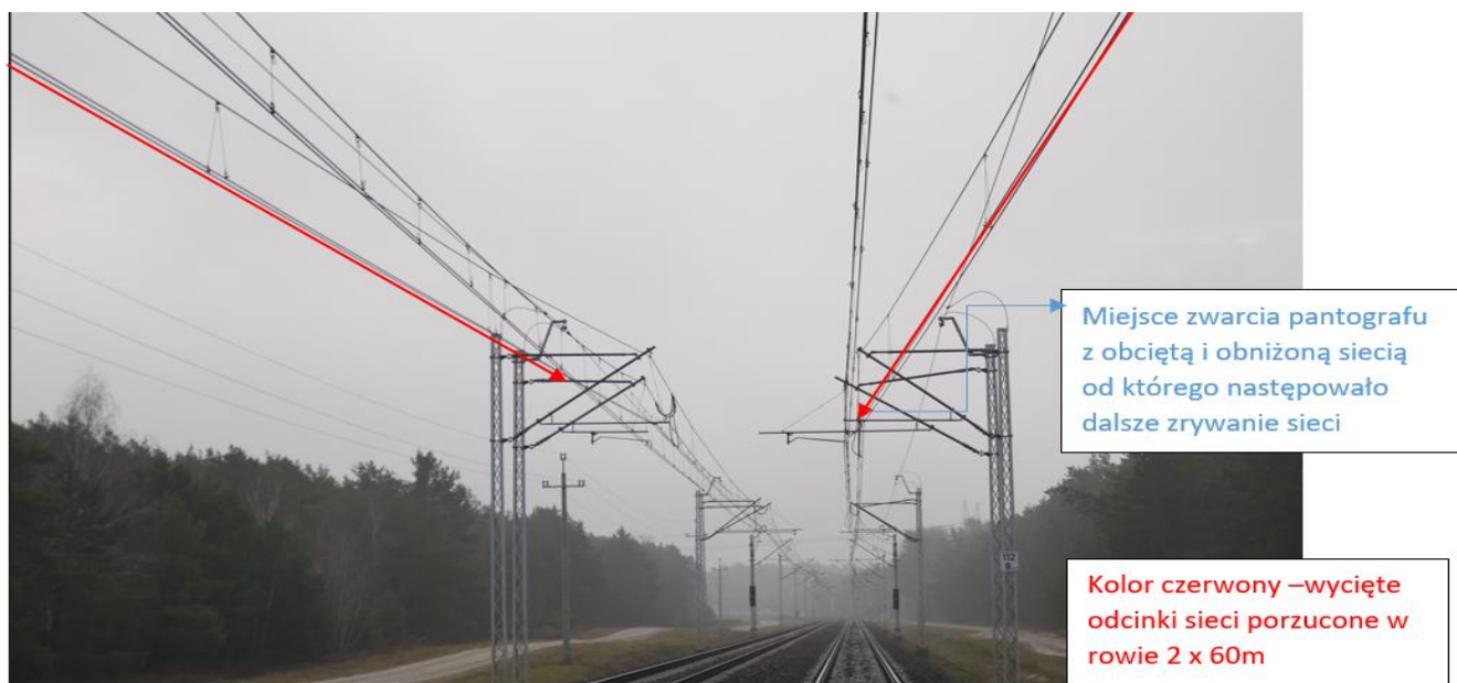
Zdjęcie 2. Miejsce kradzieży tor nr 1 i tor nr 2 oraz km 112,887 początek zrywania uszkodzonej sieci (zdj. poglądowe - materiał PKBWK)
