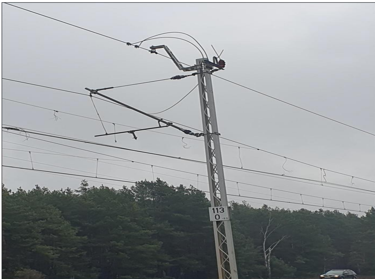
Zdjęcie 4. Widok uszkodzenia sieci trakcyjnej: zerwane wieszaki podwieszenia przewodu jezdnego, uszkodzony wspornik ramion, brak ramion odciągowych (źródło: komisja kolejowa)
