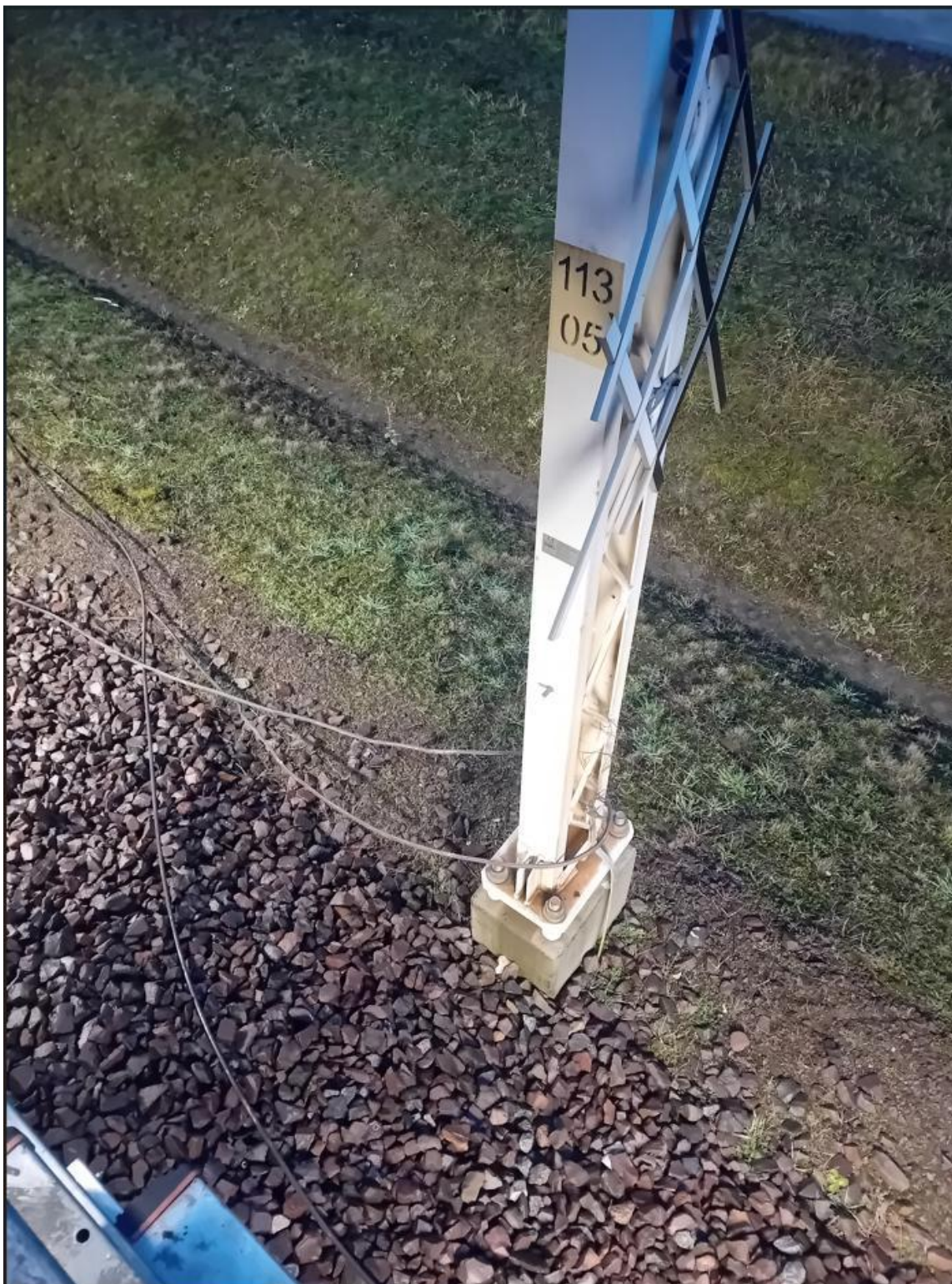
Zdjęcie 5. Widok uszkodzonego przewodu jezdnego, który został zerwany i przeciągnięty przez lokomotywę do słupa w lokacie 113-5 (źródło: komisja kolejowa)
