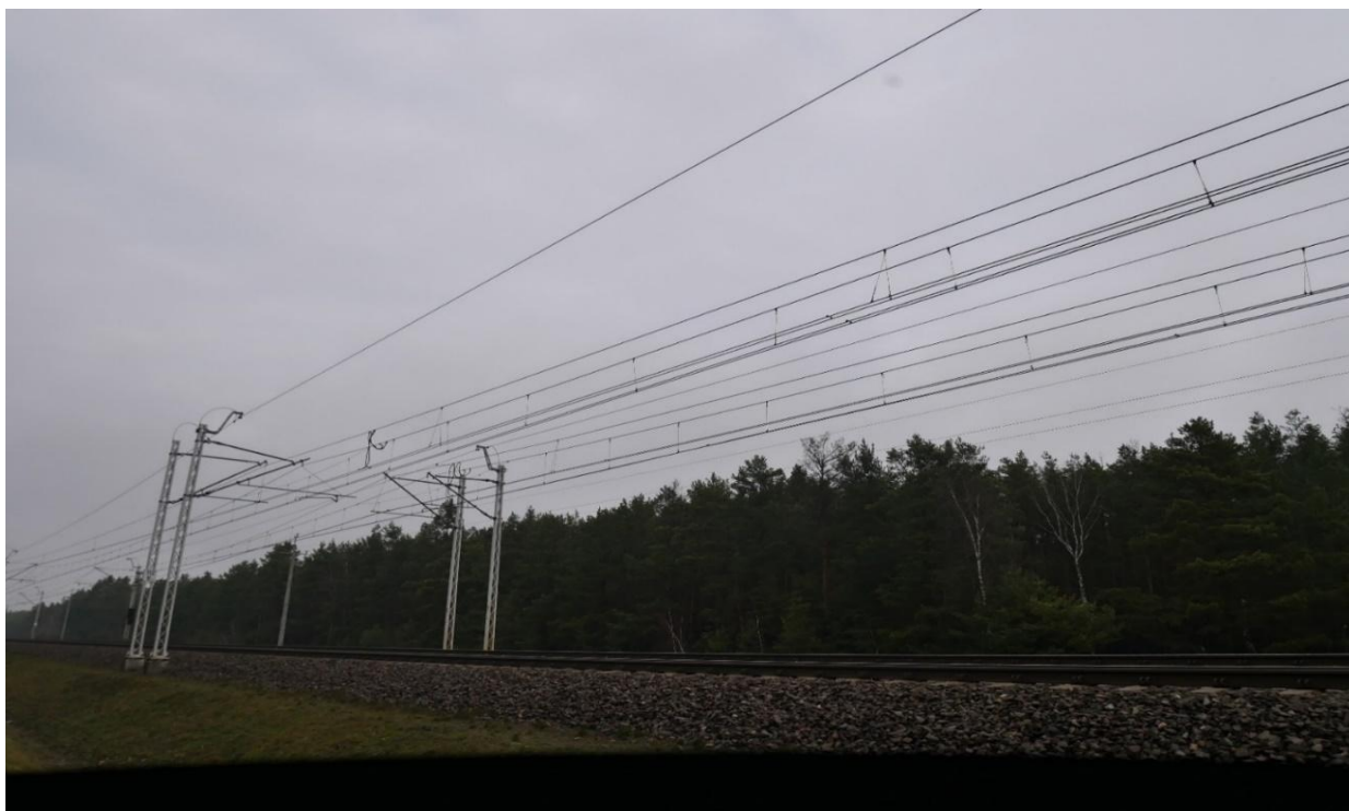
Zdjęcie 3. Widok sieci trakcyjnej typu YC150-2CS150 w miejscu zdarzenia (źródło: PKBWK)
