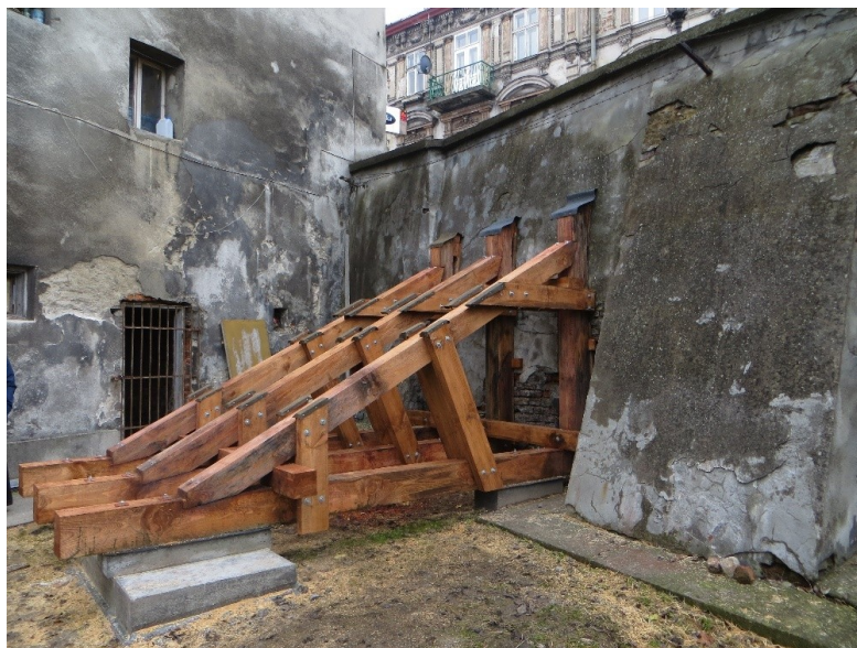
Przemyśl, zespół klasztorny o. Franciszkanów Reformatów, drewniane stemple podtrzymujące ogrodzenie od strony ul. Mniszej
