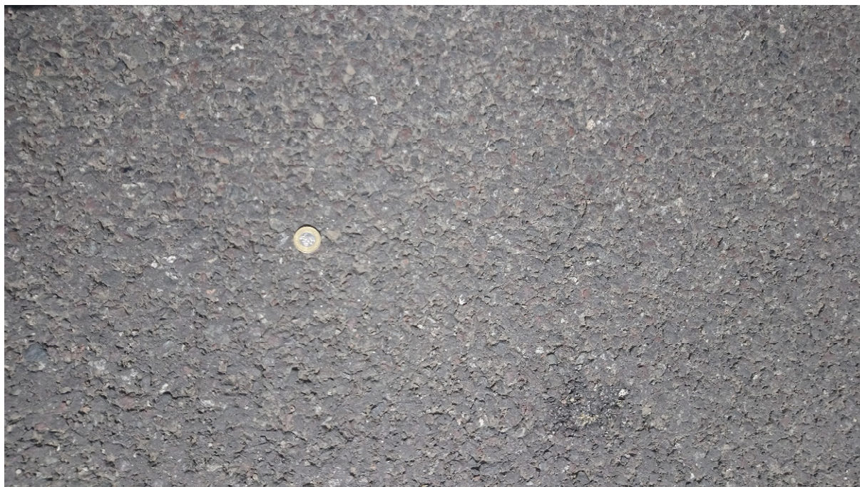
Rys. 1-12 Nawierzchnia AC11S przy punkcie P6
