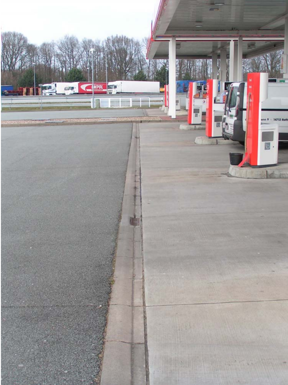
Rys. 4.13. Stacja paliw na terenie MOP. Nawierzchnia szczelna i jej odwodnienie ściekiem prefabrykowanym
