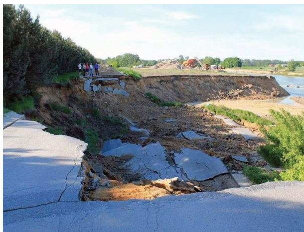
► Rys. 7. Osuwisko w ZG „Zastawie IV-2” [4]
