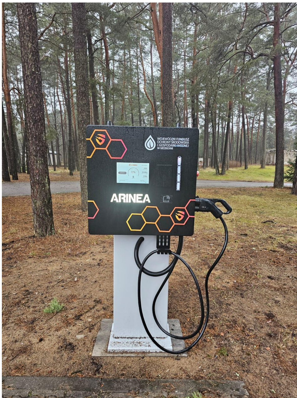
Stacja ładowania zamontowana w Ośrodku Szkolenia PSP w Bornem Sulinowie (KWSPSP Szczecin)
