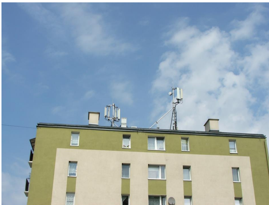
Fot. 1a, b: Widoki anten stacji bazowej: ID: GDA0030D zlokalizowanej przy ul. Polonusa Falka 3 w Gdańsku
