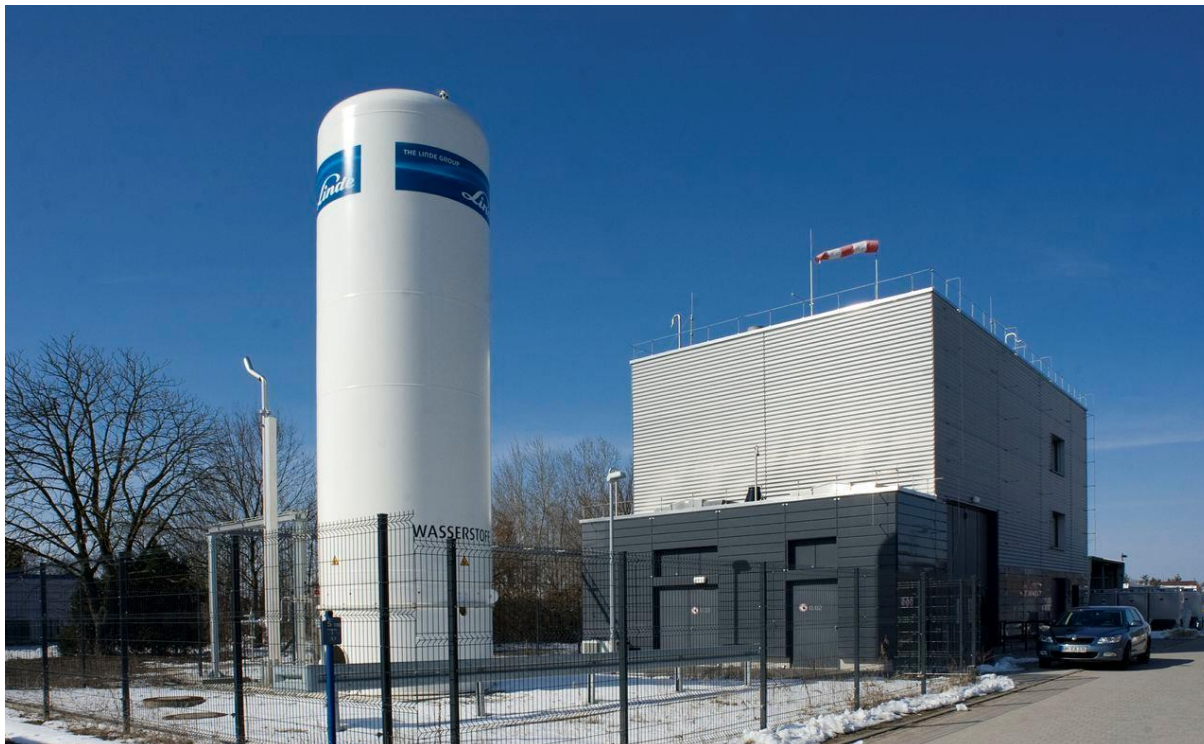
Rysunek 21-6. Zbiornik do przechowywania wodoru o pojemności 2000 m 3 pod ciśnieniem 45 bar w Centrum Badawczym Wodoru i Magazynowania w Cottbus-Niemcy https://projekt-energie.eu/pl/centrum-ksztalcenia/centrum-badawcze-wodoru-i-magazynowania-cottbus.html
