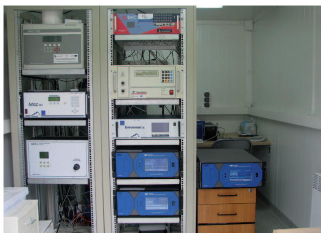
Fot. 6. Wnętrze stacji automatycznej monitoringu jakości powietrza
