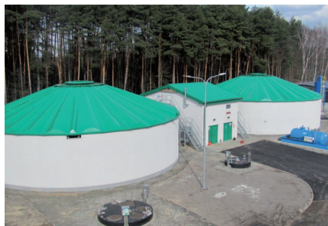
Fot. 5. Oś „LEŚNA” - widok reaktorów biologicznych
