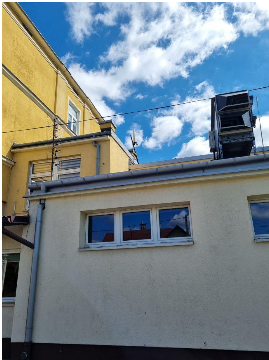
Rys. 3 Miejsce montażu SMS PEM – Szkoła Podstawowa nr 1 w Mielcu – widok z poziomu ziemi
