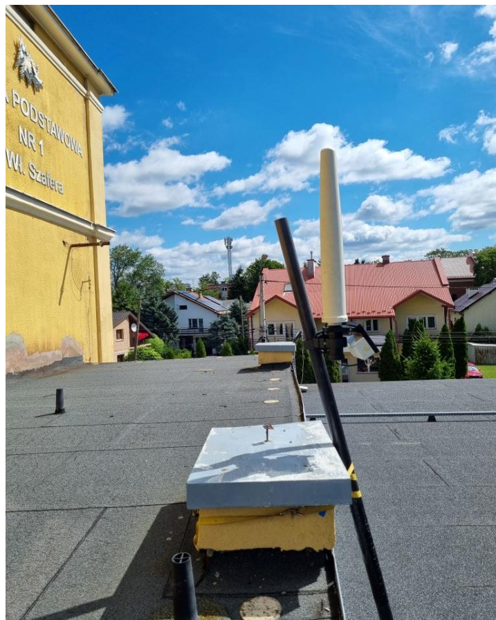
Rys. 2. Miejsce montażu SMS PEM – Szkoła Podstawowa nr 1 w Mielcu – widok na SBTK
