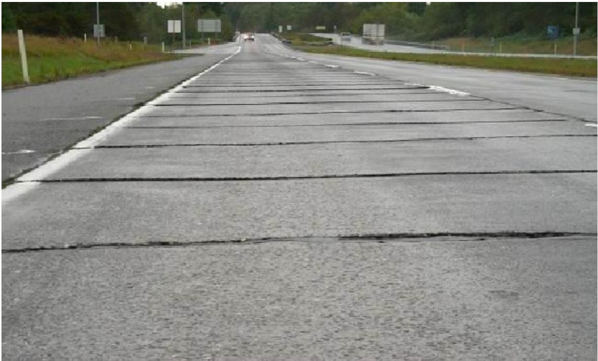
Rys. 7.2.1.4. Widok uskoków płyt
