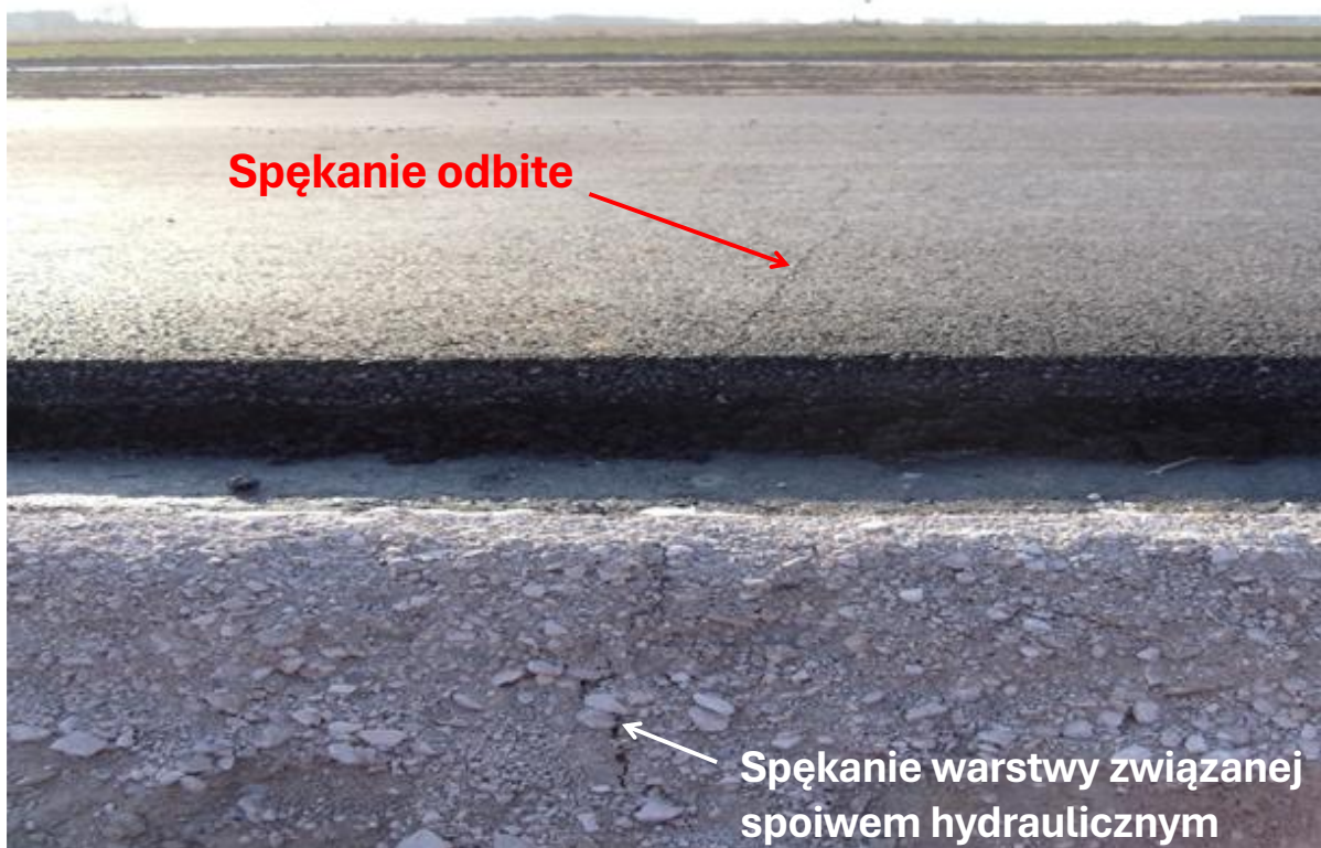
Rys. 7.1.2.15. Widok spękania termicznego odbitego (poprzecznego)
