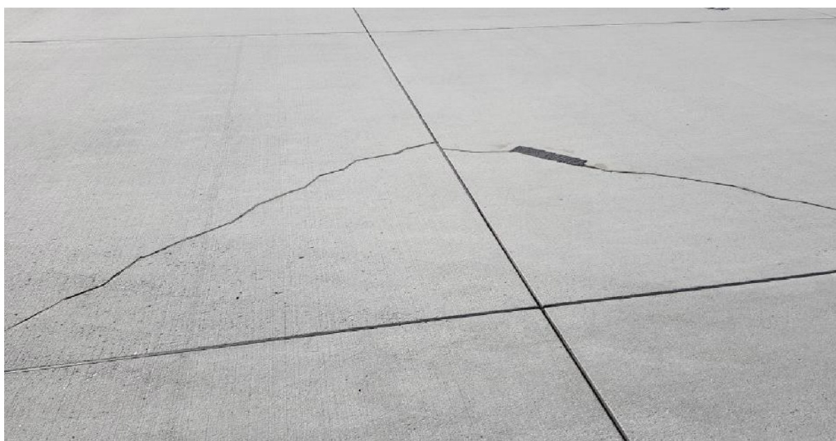
Rys. 7.2.2.6. Widok spękań naroża
