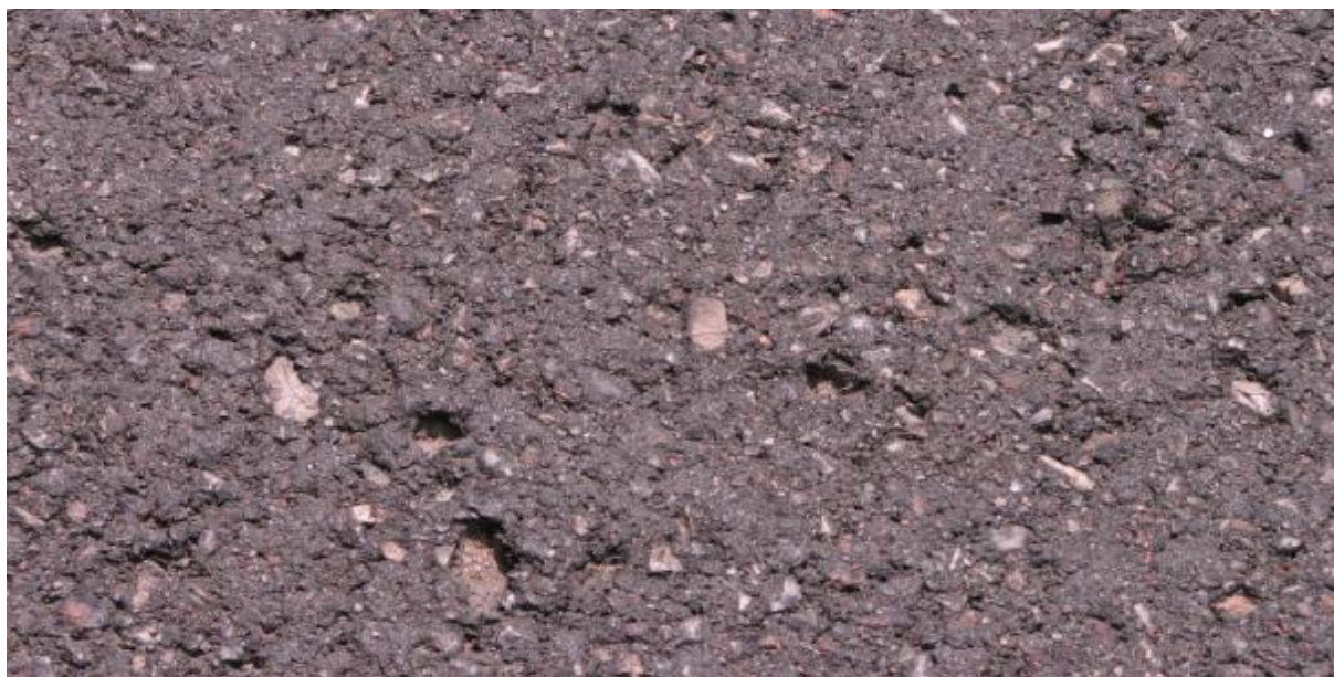
Rys. 7.1.3.1. Widok ubytków ziaren kruszywa i lepiszcza
