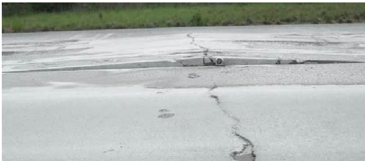
Rys. 7.2.1.2. Widok nierówności podłużnych na długości płyty
