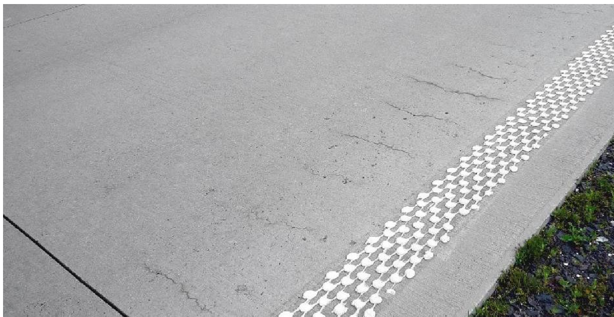
Rys. 7.2.3.6. Widok spękań spowodowany niewłaściwą pielęgnacją
