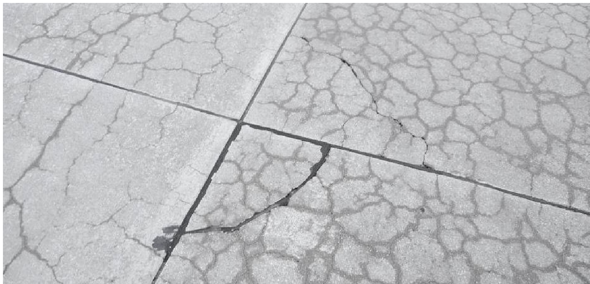
Rys. 7.2.3.4. Widok spękań alkalicznych
