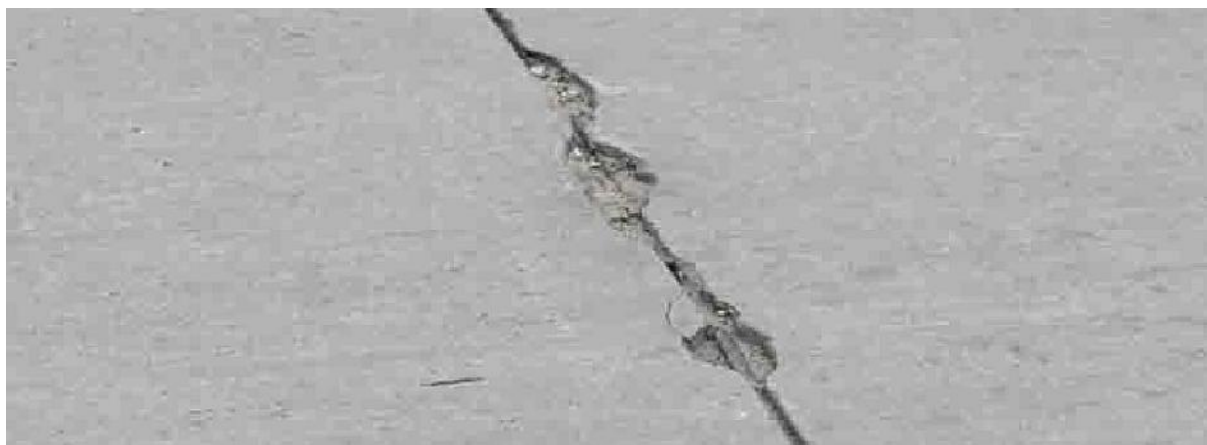
Rys. 7.2.4.5. Widok wykruszenia krawędzi szczeliny płyty
