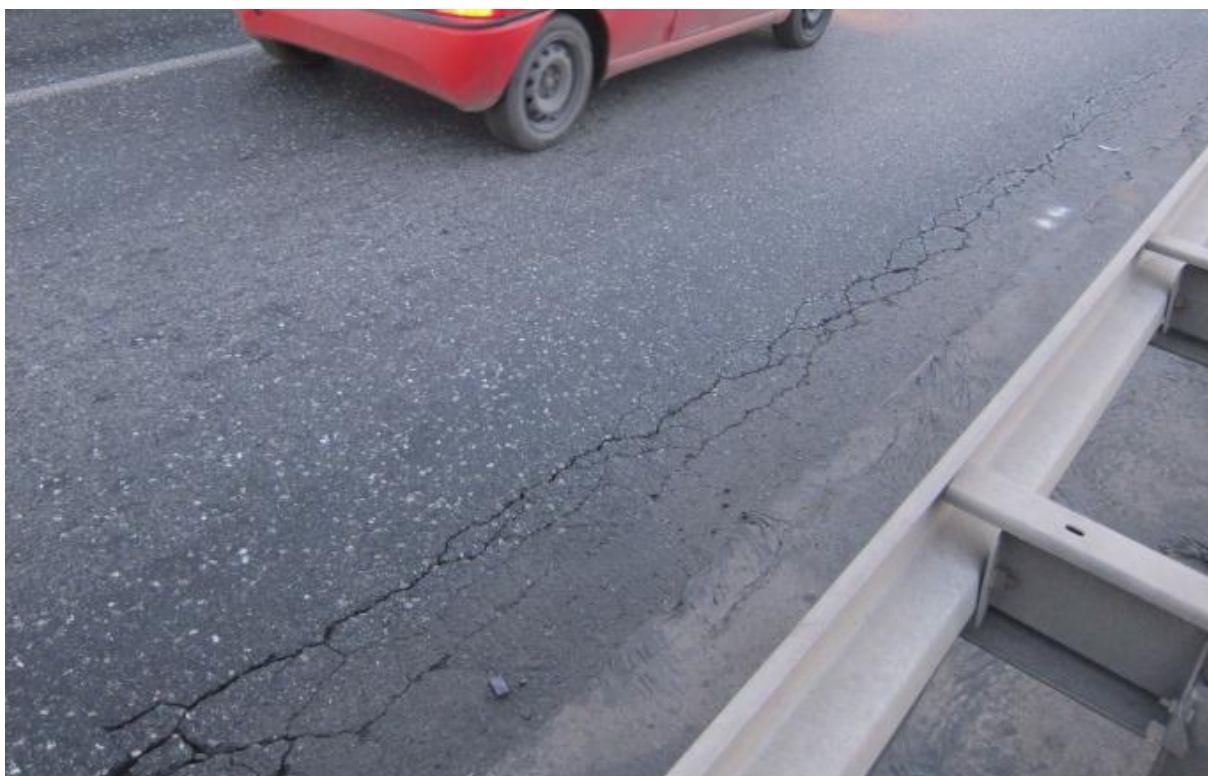
Rys. 7.1.2.7. Widok spękania zmęczeniowego podłużnego (w śladzie nierówności poprzecznej)
