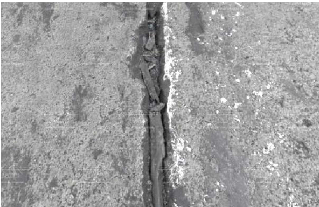
Rys. 7.2.5.1. Widok uszkodzenia wypełnień w szczelinie
