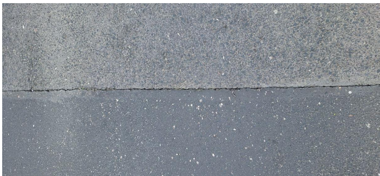
Rys. 7.1.2.11. Widok spękania termicznego pojedynczego w połączeniu technologicznym [4]
