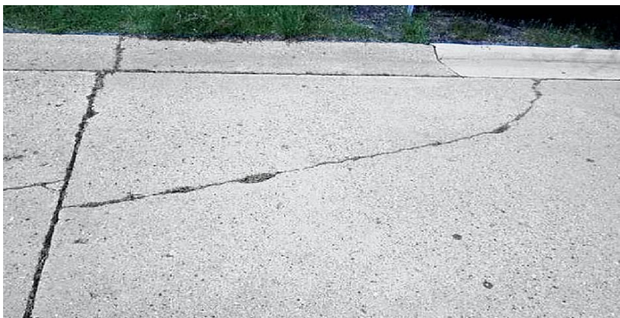
Rys. 7.2.2.7. Widok spękania naroża z częściowym wykruszeniem
