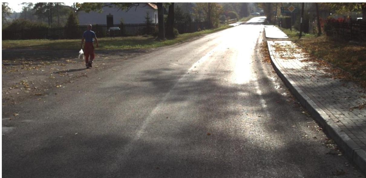
Rys. 7.1.1.4. Poziom decyzyjny ostrzegawczy: widoczna deformacja w śladzie prawego koła – głębokość koleiny GK do 20 mm [4]
