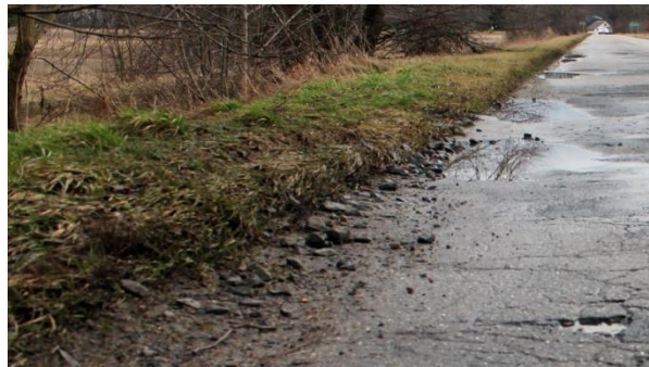
Rys. 7.4.1. Podstawowe rodzaje uszkodzeń poboczy lub części poboczy o nawierzchni gruntowej
