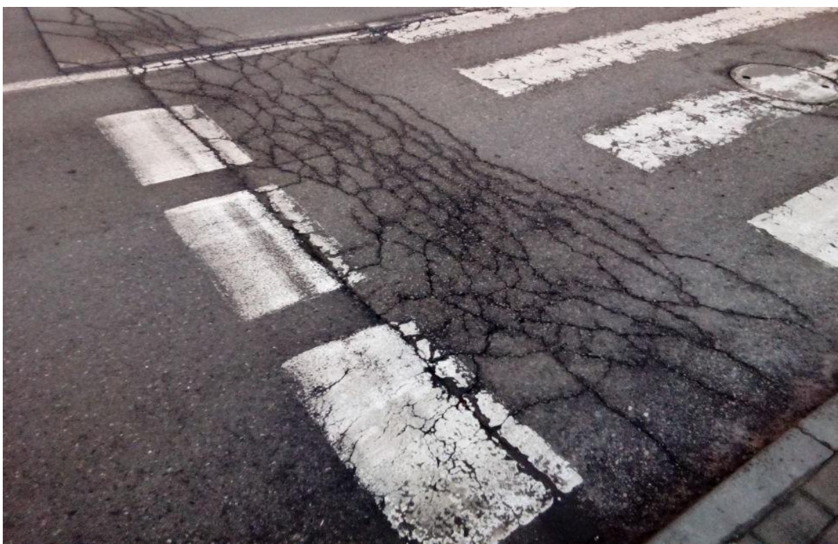
Rys. 7.1.2.5. Przykład spękania zmęczeniowego przy połączeniu technologicznym
