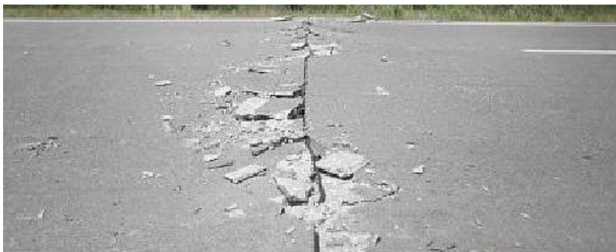
Rys. 7.2.4.6. Widok wykruszenia krawędzi szczeliny płyty
