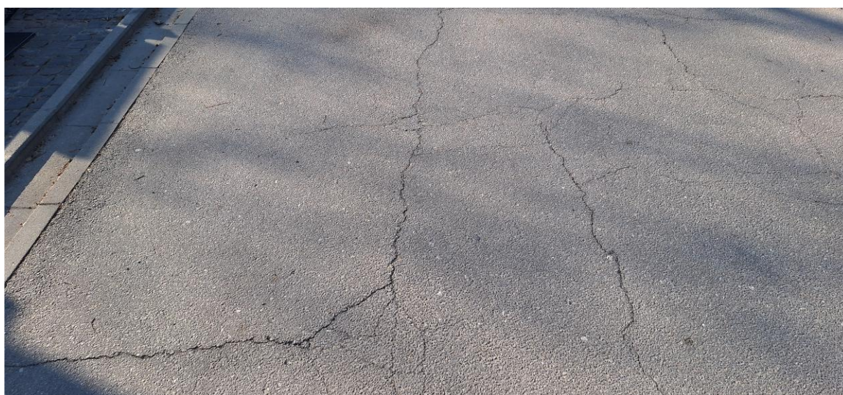
Rys. 7.1.2.13. Widok spękania termicznego zmęczeniowego (blokowego) w początkowej fazie rozwoju
