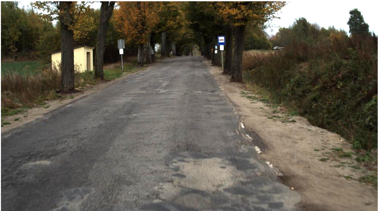
Rys. 7.1.1.5. Poziom decyzyjny krytyczny: liczne deformacje – głębokość koleiny GK powyżej 30 mm [4]
