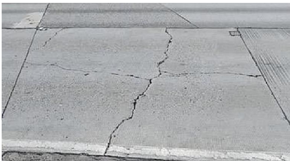
Rys. 7.2.2.9. Widok pęknięć blokowych
