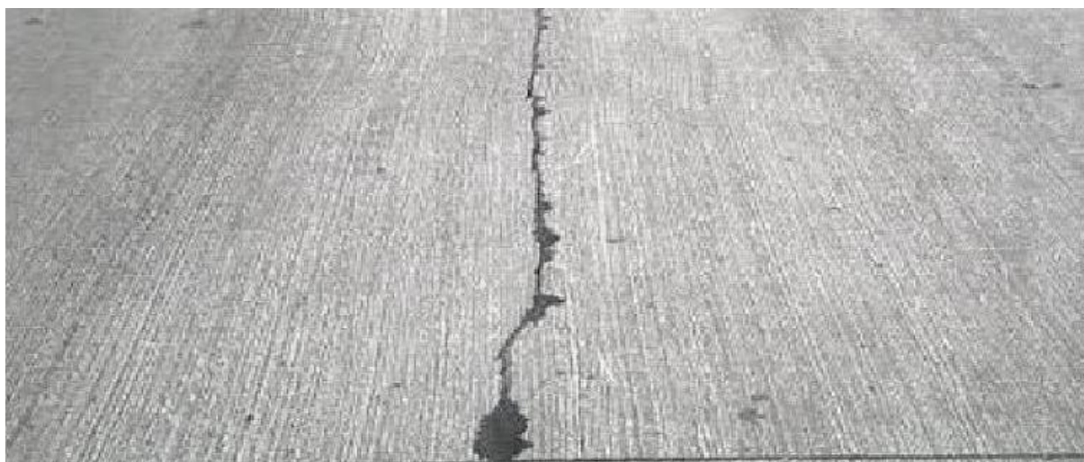
Rys. 7.2.2.1. Widok spękania podłużnego na długości płyty
