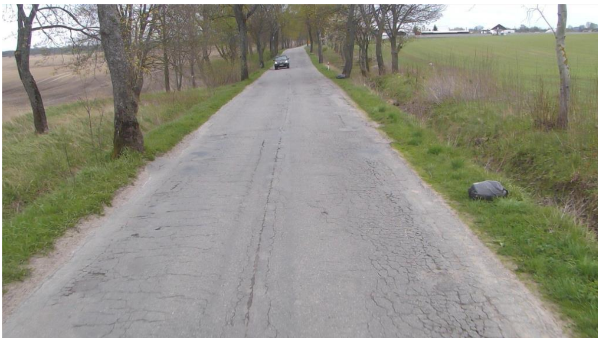
Rys. 7.1.2.4. Poziom decyzyjny krytyczny: spękania siatkowe o powierzchni SPO ponad 150 \text{ m}^2 / sekcję 100 m [4]
