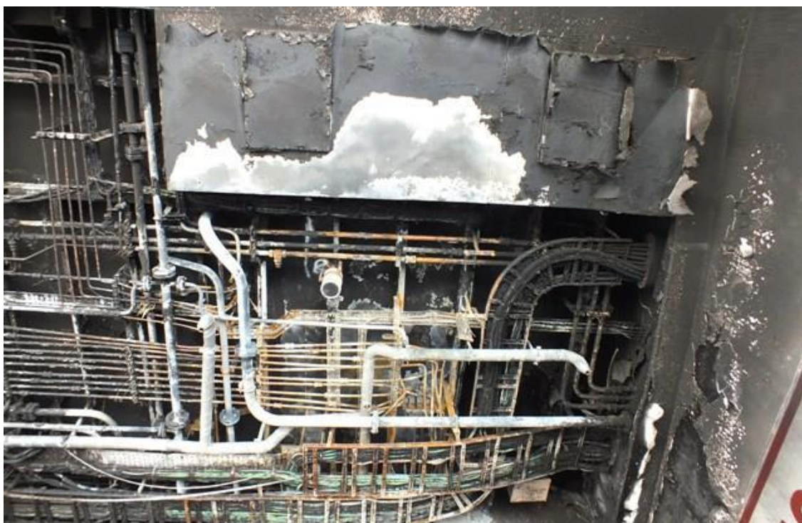
Zdjęcie nr 7. Instalacja hydrauliczna uszkodzona podczas pożaru na „STENA SPIRIT” (WIM 60/16)
