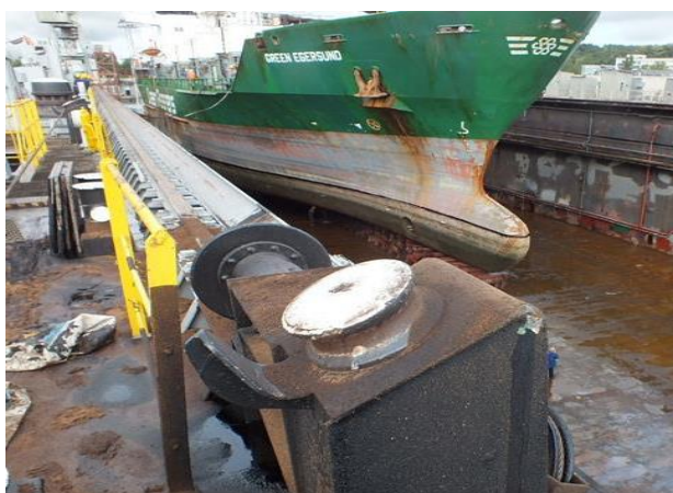
Zdjęcie nr 11. Ślady farby z kadłuba statku na krawędzi fundamentu rolki cumowniczej (WIM 39/15)
