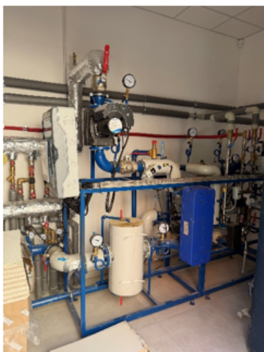
Zdjęcie nr 4 Gminny Żłobek w Łasku - Kotłownia
