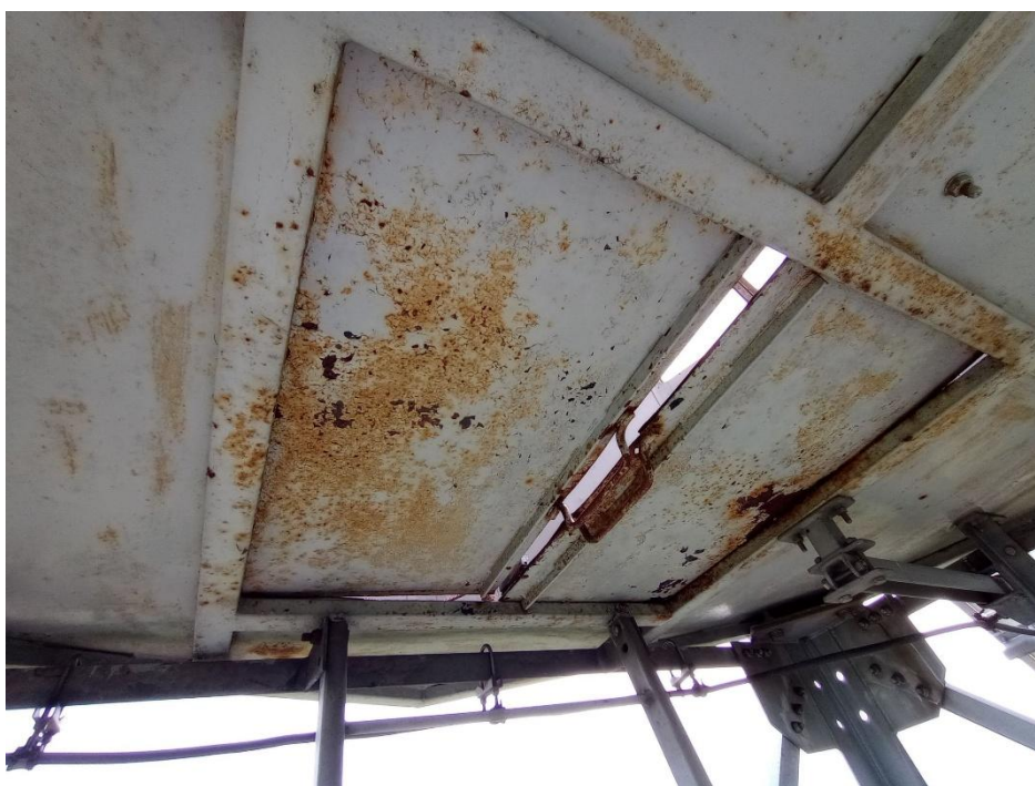
Fot. 11 – Kabina obserwacyjna - spód podłogi
