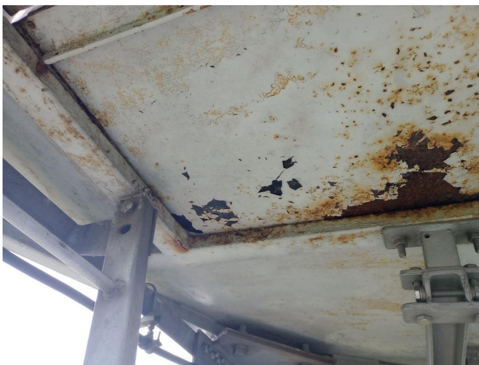
Fot. 13 – Kabina obserwacyjna - spód podłogi
