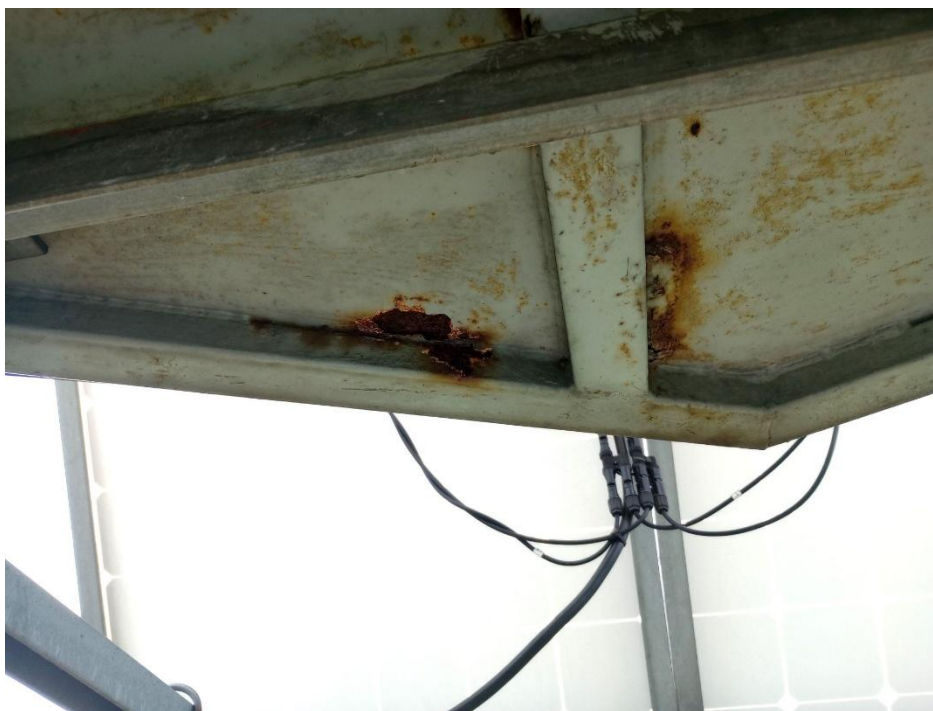
Fot. 12 – Kabina obserwacyjna - spód podłogi
