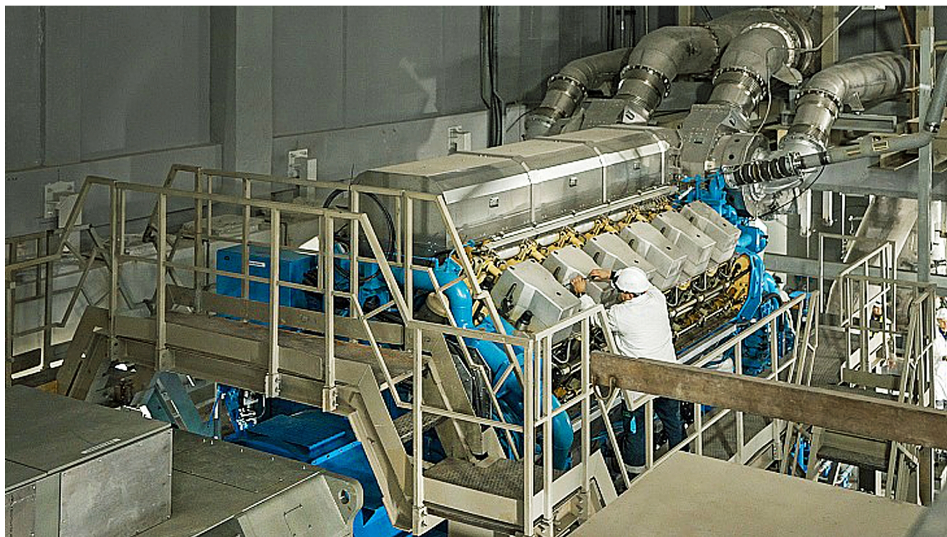
Fot. 2. Zapasowy agregat prądowłóczy w pierwszym bloku tureckiej Elektrowni Jądrowej Akkuyu. Każdy z czterech bloków będzie wyposażony w trzy takie jednostki (fot. Akkuyu NPP).
