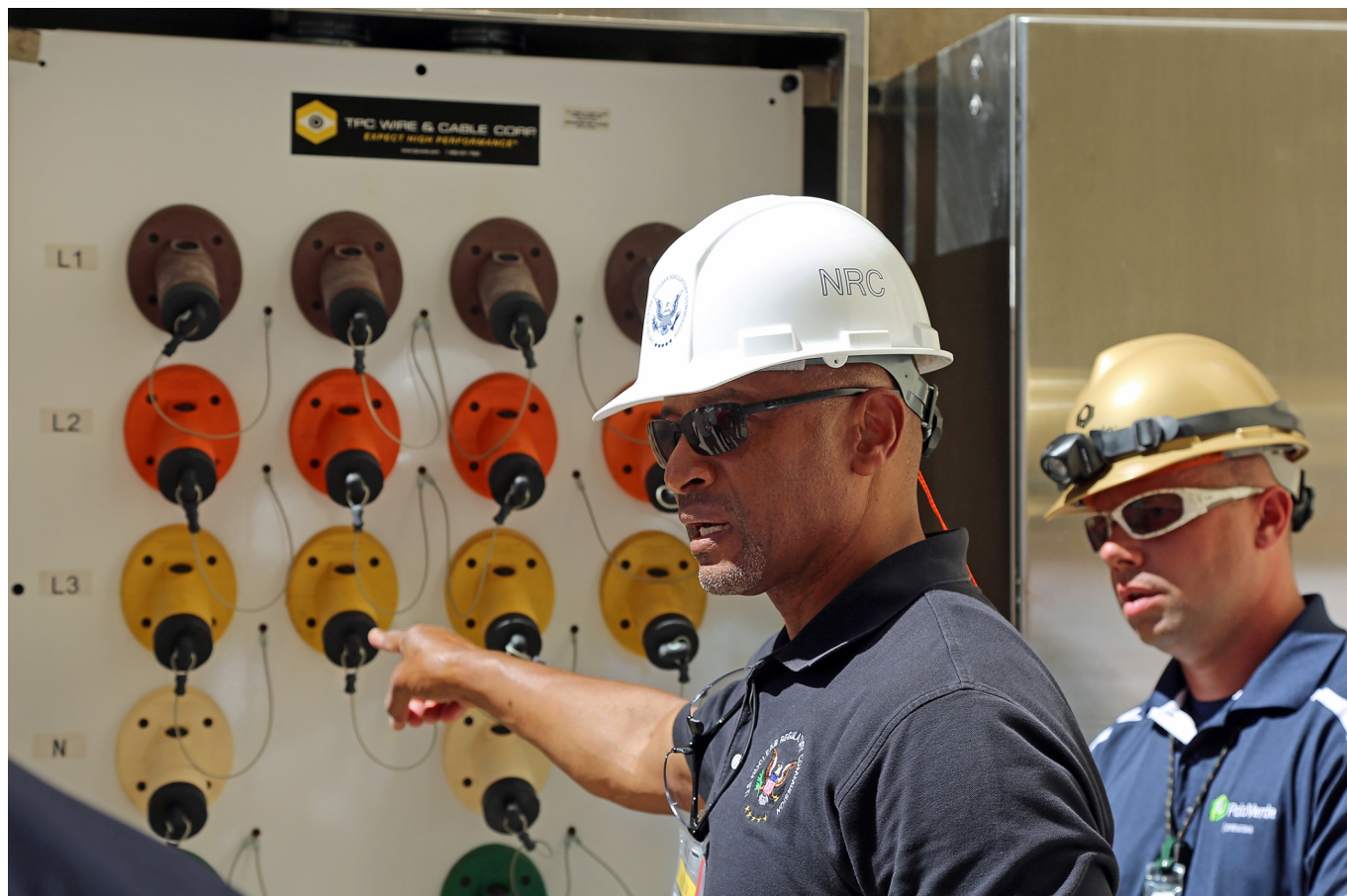
Fot. 8. Inspektorzy NRC w Elektrowni Jądowej Palo Verde w pobliżu Tonopah w Arizonie przy przyłączach elektrycznych umożliwiających podłączenie przewoźnych agregatów prądotwórczych należących do wyposażenia awaryjnego FLEX (fot. U.S. NRC).
