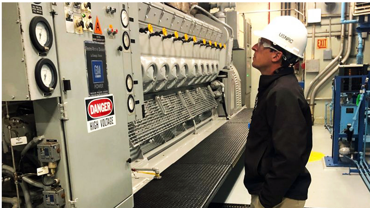
Fot. 3. Inspektor U.S. Nuclear Regulatory Commission podczas przeglądu zapasowego agregatu prądotwórczego w Elektrowni Jądrowej Beaver Valley w Pensylwanii (Fot. U.S. NRC).
