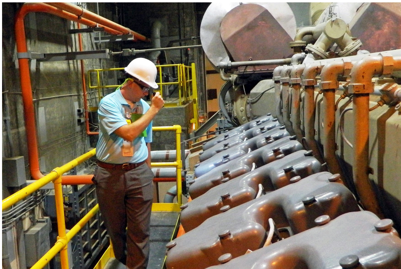
Fot. 4. Silnik wysokoprężny agregatu prądotwórczego Delaval Enterprise o mocy jednostkowej 7,7 MW. Jednostki tego typu zainstalowane w starszych blokach Elektrowni Jądrowej Vogtle 1 i 2 z lat 1980. są największe w amerykańskiej energetyce jądrowej (fot. U.S. NRC).
