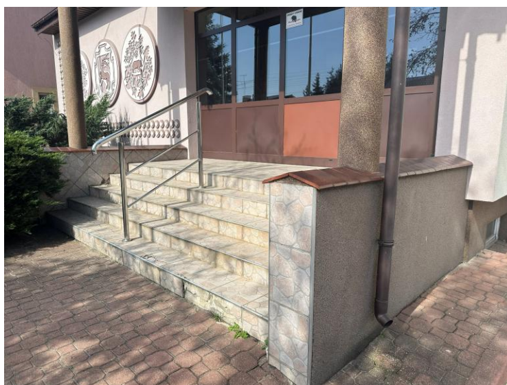
Fot. 4 Schody zewnętrzne do budynku biurowego (stan istniejący)
