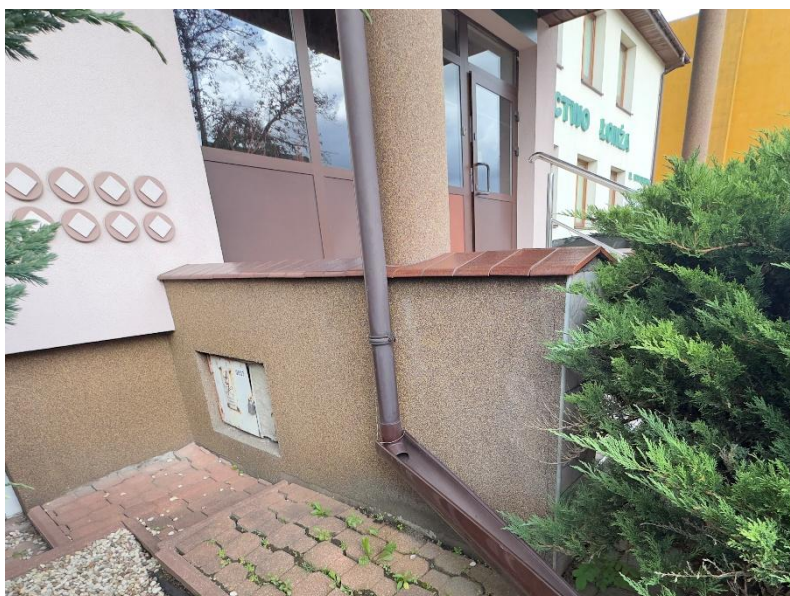
Fot. 5 Schody zewnętrzne do budynku biurowego (stan istniejący)
