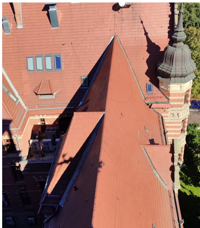
Kalenica z oderwaną częścią instalacji odgromowej.
