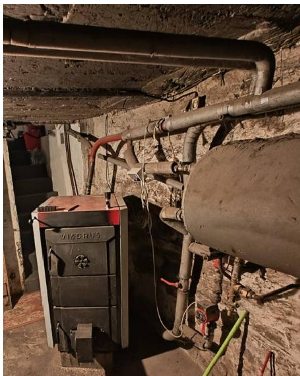
Dokumentacja fotograficzna 1 Istniejąca kotłownia
