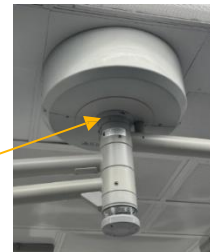
Ilustracja 1: Element, którego dotyczy problem: pierścień sufitowy
