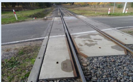
Zdjęcie 13 – Widok stanu technicznego przejazdu kolejowego z kierunku jazdy samochodu osobowego (źródło: materiały przekazane przez komisję kolejową)
