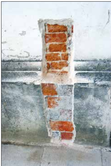
2. Kraśnik, kościół parafialny, odkrywka stanu muru ceglanego, fot. B. Stolarz, 2008
