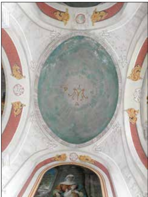
36. Tarnobrzeg kościół pw. Przemienienia Pańskiego, malowidła ścienne, fragment, nawa boczna, stan przed pracami, fot. M. Filip, 2016
