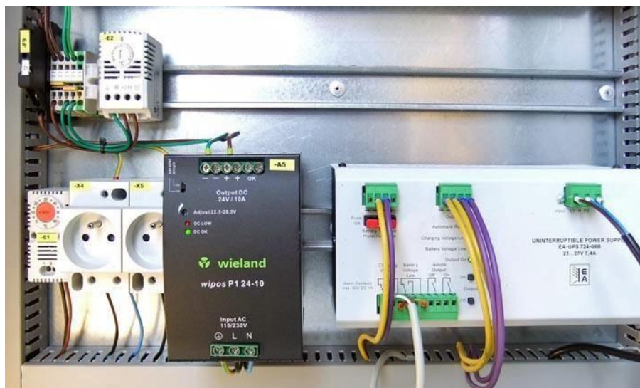
Termostat –E2 (ustawiony na 30°C) UPS 230 V / 24 V Termostat –E1 (ustawiony na 10°C)
