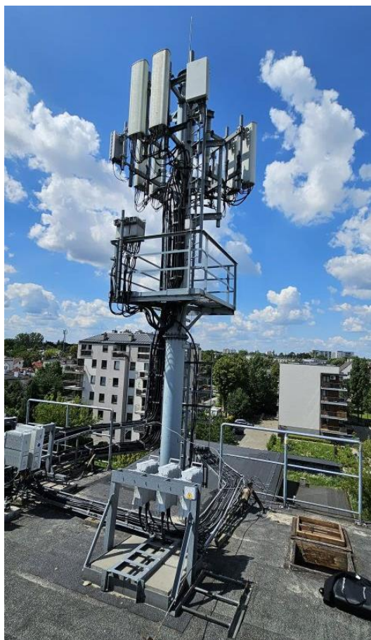
Rys. 3 Widok na SBTk z miejsca montażu SMS PEM – Biblioteka WHUŚ
