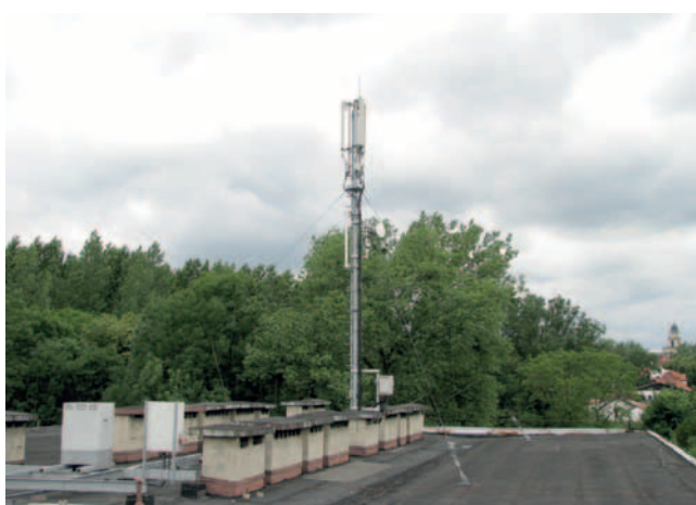
Fot. 2. Stacja bazowa telefonii komórkowej w Bytomiu
