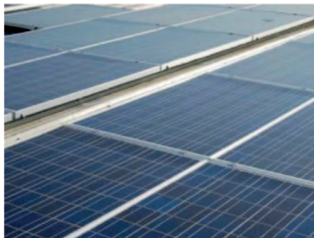
Fot. 2. Instalacja fotowoltaiczna Szpitala Reumatologiczno-Rehabilitacyjnego w Ustroniu
