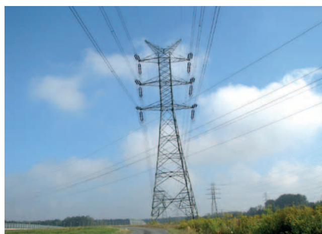
Fot. 3. Elektroenergetyczna linia przesyłowa 400 kV
