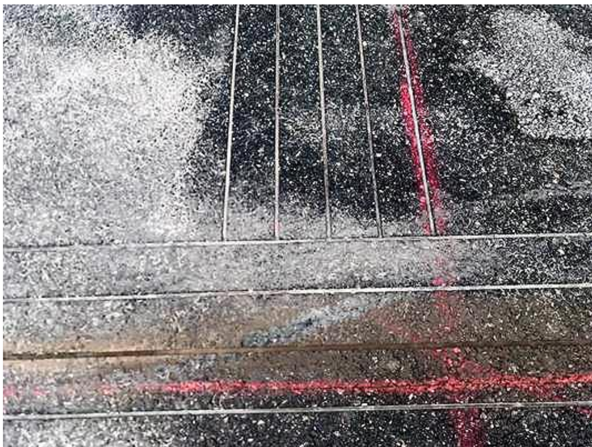
Rys. 12.6.2. Przykład systemu rowkowania warstwy ścieralnej nawierzchni na istniejącej rampie drogowej (fragment) – szczegół (źródło: zdjęcie wykonawcy rowków)
