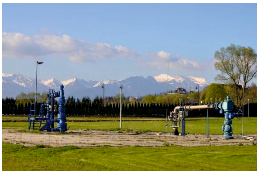
Geothermal wells, Podhale (Poland) source: PEC Geotermia Podhalańska SA
