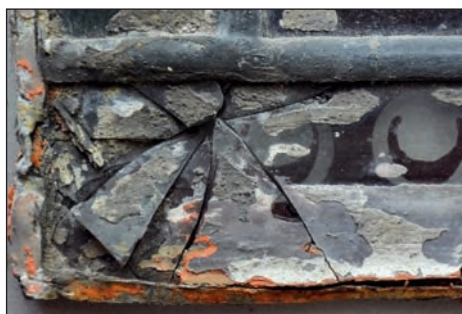
Fot. 5. Fragment wielokrotnie spękanego szkła w witrażu, stan przed konserwacją, fot. K. Kuchno, 2021
