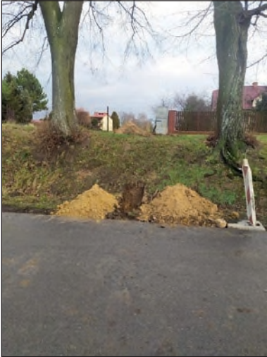
Fot. 5, 6. Prowadzenie prac przy układaniu instalacji światłowodowej w obrębie alei lipowej w m. Nasutów, gm. Niemce. Pierwsze ze zdjęć przedstawia niewłaściwe wykonanie prac, wstrzymane interwencyjnie przez pracowników WUOZ w Lublinie. Drugie ze zdjęć wykonano w późniejszym terminie, prace wykonywano pod nadzorem dendrologa (fot. K. Karkuszevska, 2020 r. i 2022 r.)
