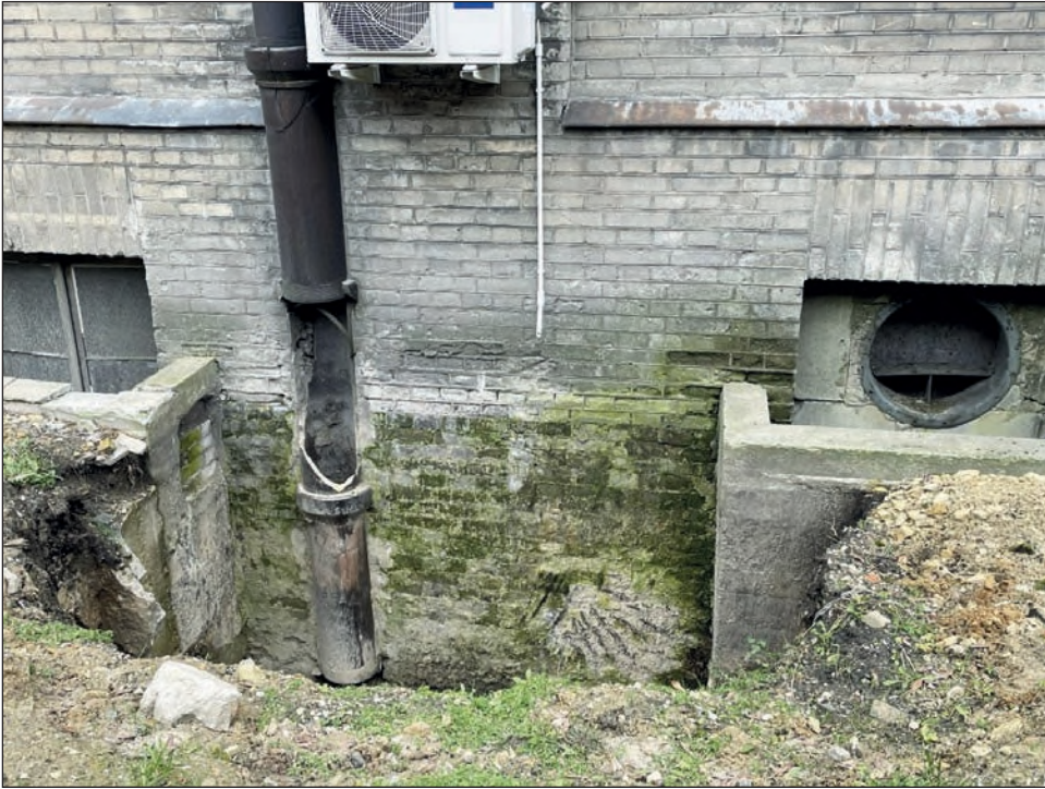
Fot. 2. Budynek A – widok jednej z zachowanych kamionkowych rur spustowych elewacji północnej, 2023 r., K. Janus
