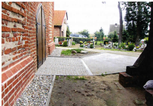
Ryc. 21. Ostatni akt działań to budowa zjeżdżalni dla wody. To co widać na fotografii, nie jest mistyfikacją, lecz faktem. Wysoki chodnik okalający kościół połączono z niższym poziomem wejścia do kościoła. Ponieważ cienka nitka odwodnienia liniowego nie radzi sobie z wodą podczas większego deszczu, dlatego pod dzwonicą (po prawej stronie) stoją w pogotowiu worki z piaskiem, którymi przed każdym deszczem zabezpieczane są drzwi wejściowe do kościoła. Fot. B.J. Rouba
