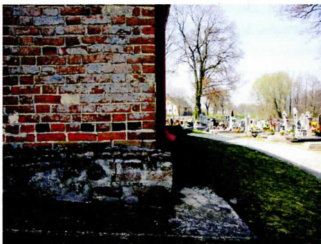
Ryc. 3. Narożnik zakrystii od strony wschodniej, widoczne to samo pęknięcie. Najprawdopodobniej rozmiękczenie gruntu wodą wylewaną z rury spustowej w jeden punkt i przy tym obciążenie betonową opaską sprawiło, że narożnik wisi już właściwie w powietrzu. Fot. B.J. Rouba
