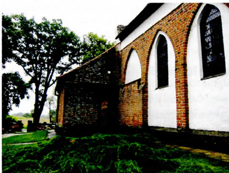
Ryc. 1. Przykład kościoła, w którym pierwszą przyczyną zawilgocenia jest infiltracja wody w mur na skutek podwyższenia poziomu gruntu aż o 50 cm (co ustalono, porównując rzędne terenu z poziomem posadzki we wnętrzu). Infiltracja jest wzmacniana przez przykrycie gruntu od góry bardzo solidną betonową opaską, co jest drugą przyczyną zawilgocenia. Stan w roku 2011. Fot. B.J. Rouba
