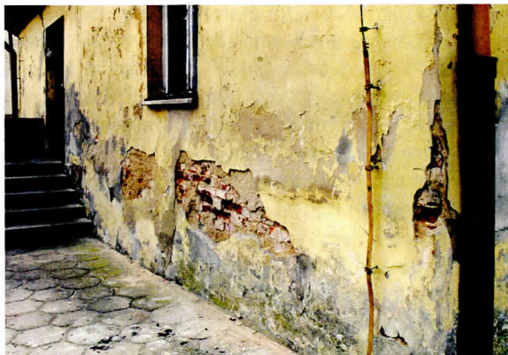
Ryc. 8. Budynek dawnej wozowni klasztornej, współcześnie użytkowany był jako szkoła. Podczas remontu w latach 70. wykonano naprawę tynków w strefie przyziemia z użyciem mocnej zaprawy cementowej, a nawierzchnię dziedzińca pokryto sześciobocznymi płytami, co przyczyniło się do intensywnego niszczenia budynku. W strefie odprowadzania wody widoczna głęboka korozja cegieł – stan w roku 2006. Fot. B.J. Rouba
