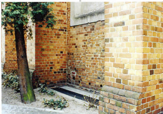
Ryc. 13. Wschowa – w trzecim rzędzie cegieł widoczne rurki Knapena zamontowane najprawdopodobniej jeszcze w okresie przedwojennym. Nawet jeśli rurki początkowo działały, to w latach 80. XX wieku kościół był na tyle zawilgocony, że podjęto kolejne działania dla jego osuszenia. Rozwiązanie zaprojektowane przez inż. A. Trybuna na przełomie lat 80. i 90. to otwarte kanały wentylujące przyziemie kościoła, dołem połączone z kanalizacją burzową, co umożliwia odprowadzenie wody, która się do nich dostaje podczas deszczu. Wewnątrz kościoła – dla zrównoważenia parcia mas ziemi na ściany – także wykonano kanał, wentylowany już jednak tylko małymi kratkami, rozmieszczonymi w odstępach około 2 m. Fot. B.J. Rouba
