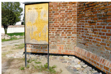
Ryc. 14. Rok 2006 – świeżo zakończone prace przy odwodnieniu gotyckiego kościoła. Podczas deszczu woda po prostu musi spływać po ścianie za folię ułożoną bez górnego zamknięcia. Kamienie dadzą natomiast odprysk, który będzie wzmacniał zawilgocenie dolnej partii ścian. Dziś stan kościoła jest opłakany. Fot. B.J. Rouba
