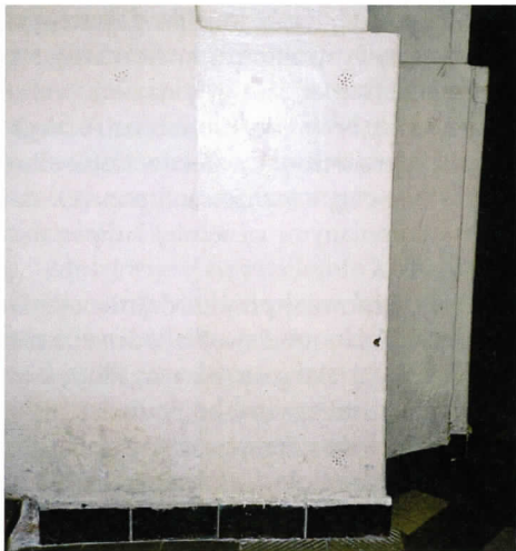
Ryc. 9. Kościół w Głubczycach. Problemy z zawilgoce- niem istniały w nim od dawna, czego świadectwem są ekrany ukrywające widok zawilgoconych ścian, wyko- nane jeszcze w okresie przedwojennym. Widoczne na fotografii niewielkie rozetki miały zapewniać wenty- lowanie przestrzeni między ekranem a mokrą ścianą. Stan w roku 2003. Fot. B.J. Rouba
