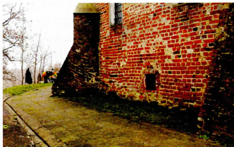
Ryc. 6. Wzdłuż wschodniej ściany prezbiterium spadek już nie jest tak wyraźny, stąd większe zawilgocenie i zniszczenia. Natomiast po lewej stronie fotografii, nad samą krawędzią skarpy widoczne jest uszkodzenie i zapadnięcie chodnika. Fot. B.J. Rouba
