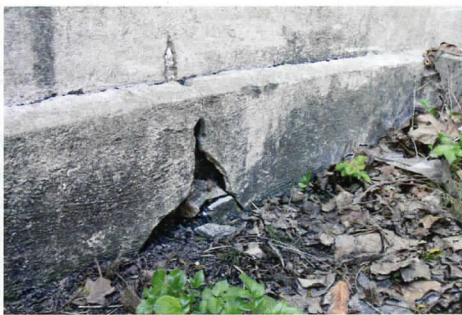
Ryc. 12. W miejscu uszkodzenia odsadzki widać pustą przeźródzeń jej wnętrza. Fot. B.J. Rouba
