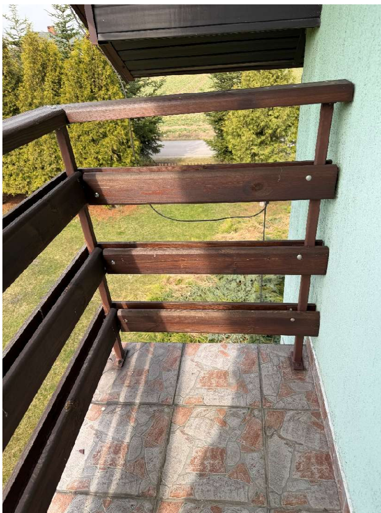
Zdj. nr 2 – widok posadzki balkonu oraz balustrady w kierunku północnym
