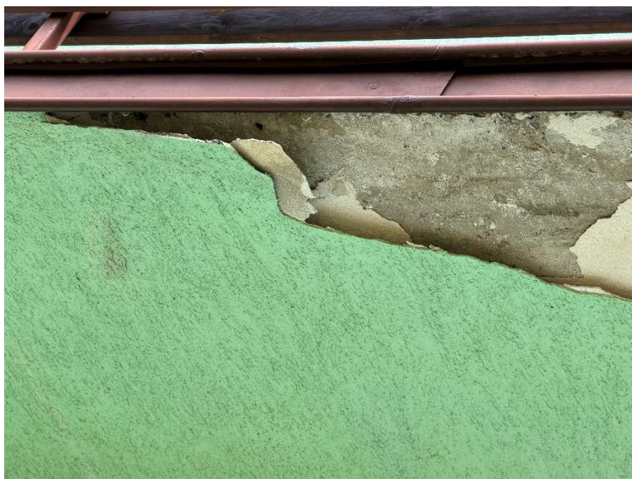
Zdj. nr 3 i 4 – widok odspojonego tynku
