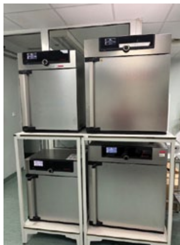
Cieplarki laboratoryjne w Pracowni Mikrobiologii
