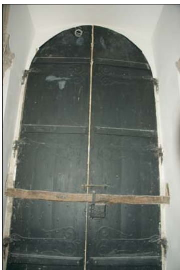
64. Zamość, Katedra, odwrocie drzwi wejściowych, stan przed konserwacją, fot. M. Filip, 2014 r.
