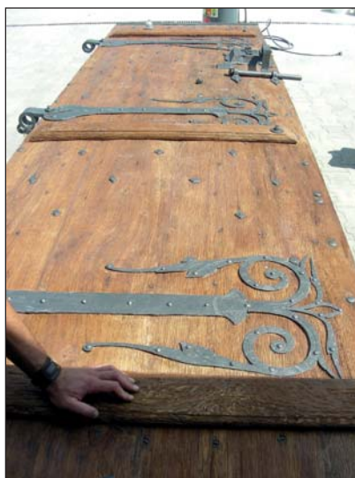
65. Zamość, Katedra, odwrocie drzwi wejściowych zachodnich, stan po konserwacji, fot. M. Filip, 2014 r.
