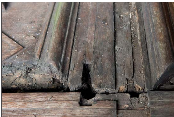
3. Fragment drzwi z widocznymi uszkodzeniami i ubytkami drewna, fot. K. Szyrkarczuk, 2014.
