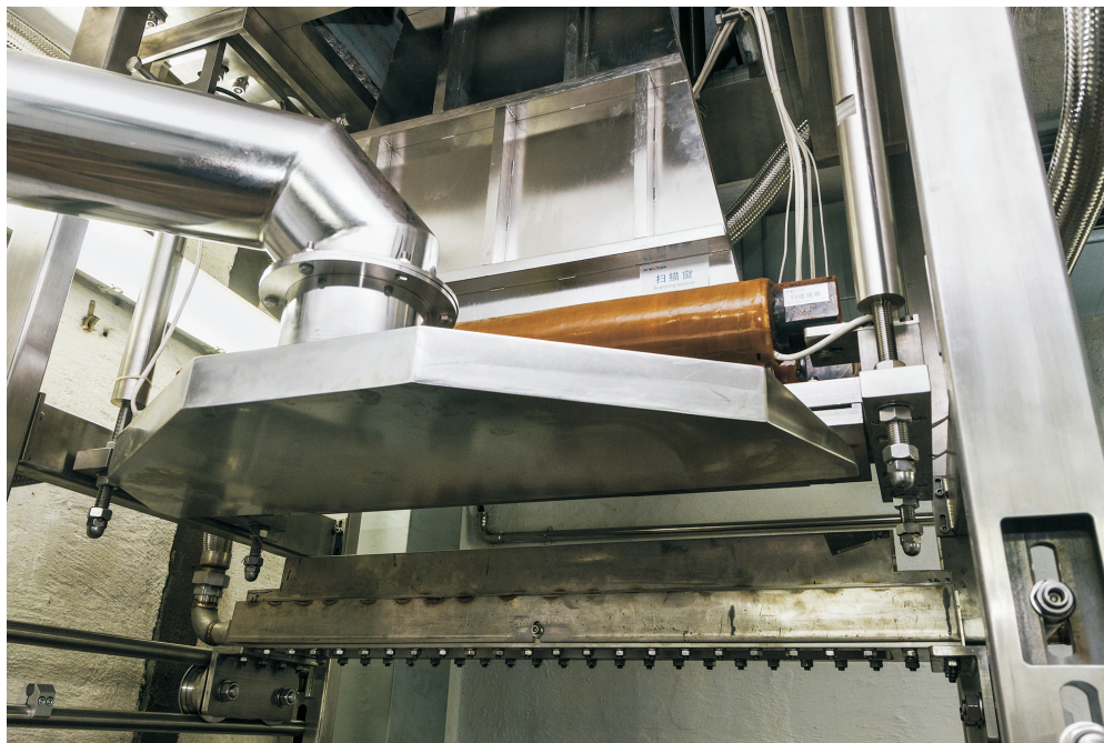
Fot. 2. Instalacja do konwersji wiązki elektronów na promieniowanie hamowania nowego akceleratora w Stacji Sterylizacji Radiacyjnej Wyrobów Medycznych i Przeszczepów w IChTJ (źródło: IChTJ).
