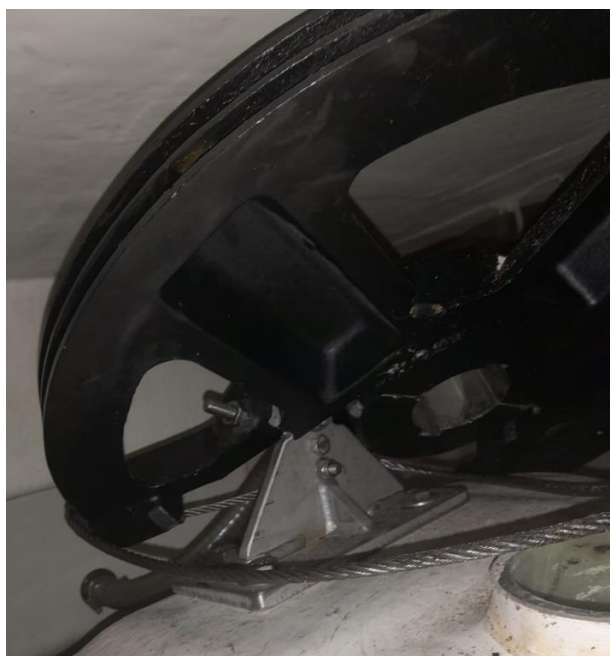
Zdjęcie 9. Uszkodzony kwadrant sterowy
