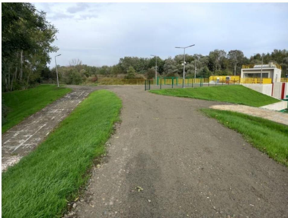
Foto. 51. Stan terenu budowy w pierwszym miesiącu okresu zgłaszania wad – wał przeciwpowodziowy na zachodnim brzegu kanału portu Kujawy, stan w drugiej dekadzie października 2023 r. (widok w kierunku północnym).
