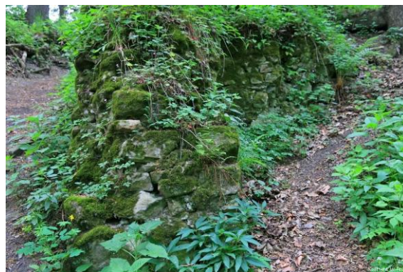
Fotografia 2. Zamek Barwałd, pozostałości murów od strony pd.-wsch.
