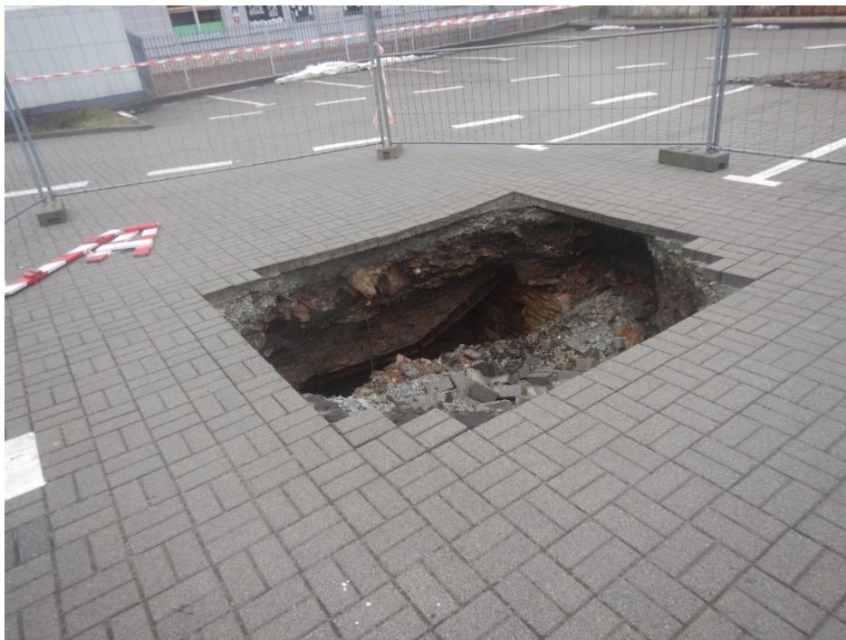
Fot. 2 Zapadlisko na parkingu przy ulicy Szpitalnej w Olkuszu.
