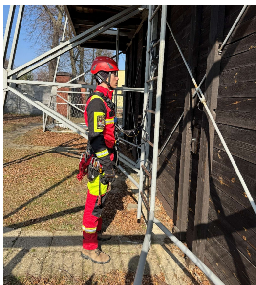
Rysunek 13. Ratownik przystępujący do poruszania się po konstrukcji z asekuracją poprzez wykorzystanie lonży typu Y z absorberem
