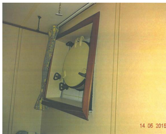
Zdjęcie nr 7. Uszkodzenia bulaja w jednej z kabin załogowych na statku „Fast Jef”
