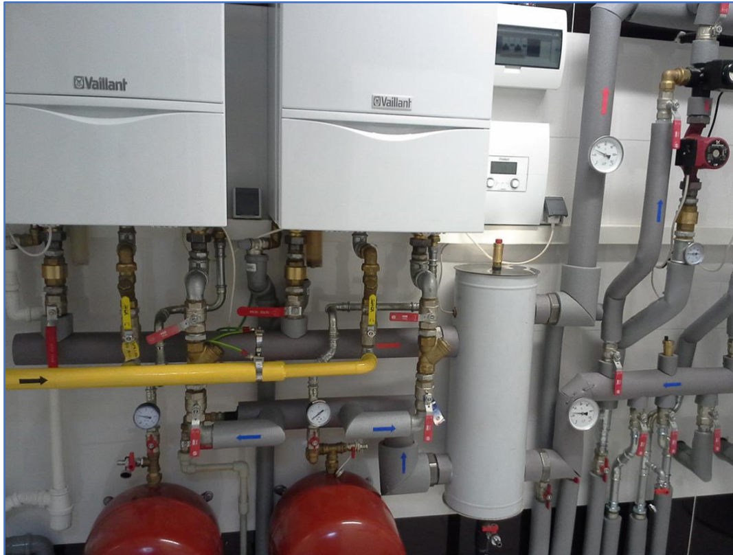
Pic. 1 Zagórski systemy grzewcze: Central heating installation
