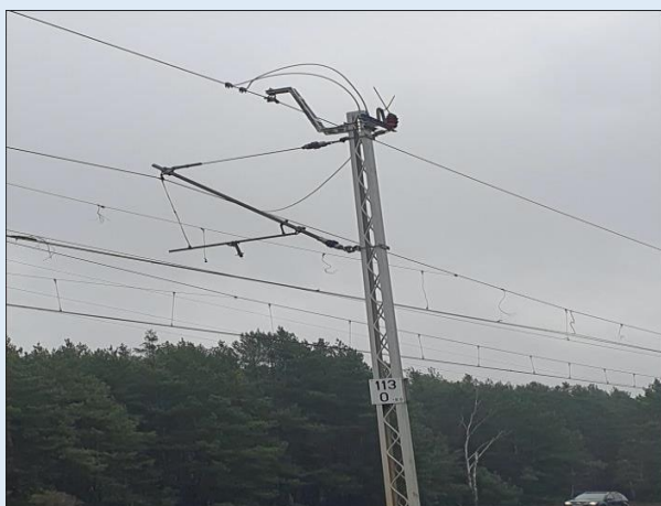
Zdjęcie 13 - Widok uszkodzenia sieci trakcyjnej: zerwane wieszaki podwieszenia przewodu jezdnego; uszkodzony wspornik ramion - brak ramion odciągowych (źródło: materiał przekazany przez komisję kolejową)
