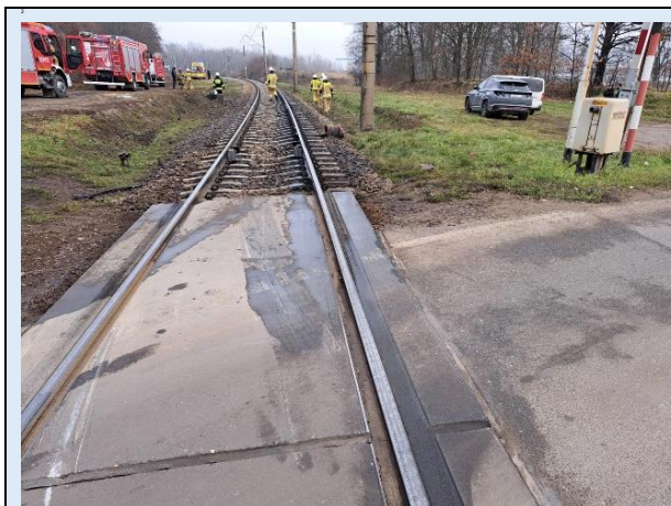
Zdjęcie 22 - Skutki zdarzenia na przejeździe kolejowym (źródło: materiały przekazane przez komisję kolejową)
