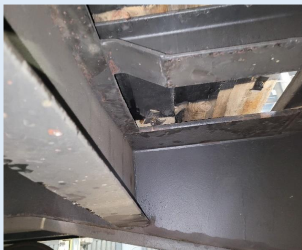
Zdjęcie 20 - Skutki zdarzenia - ślady wybuchu na podwoziu wagonu platformy (źródło: materiały przekazane przez komisję kolejową)
