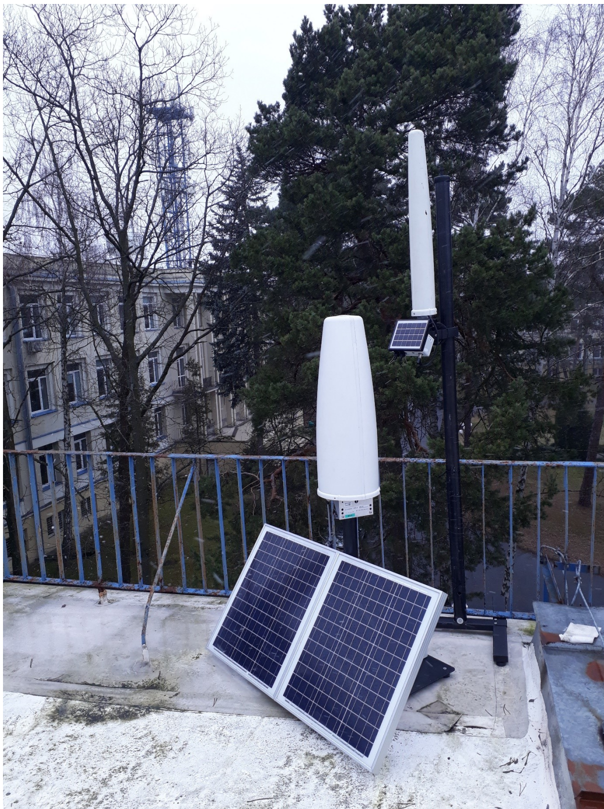
Rys. 6 Miejsce montażu SELMS PEM – Ik-PIB w Warszawie – lokalizacja 2, widok na SBTK
