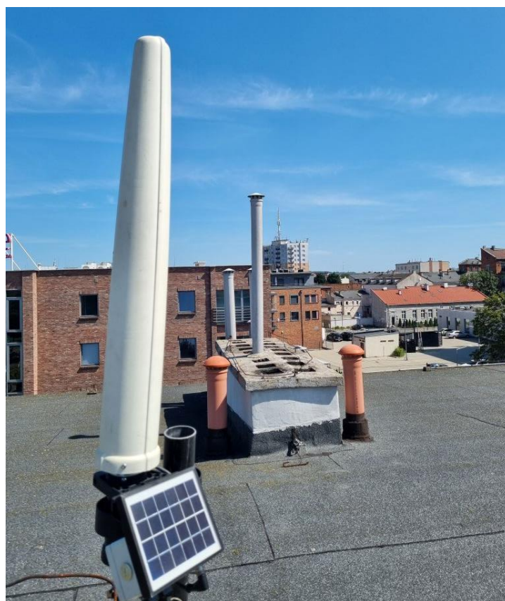
Rys. 2. Miejsce montażu SMS PEM – Budynek, ul. Pułaskiego 3
