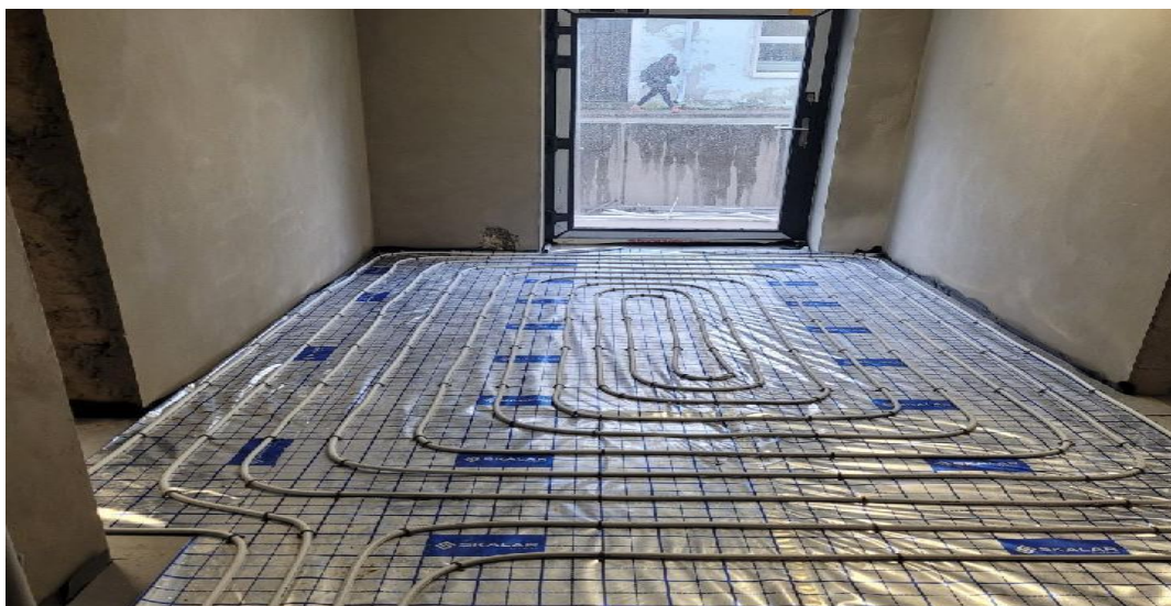
Zdjęcie nr 11. Nowa instalacja grzewcza w Przychodni Zespołu Lekarzy Rodzinnych MEDICUS przy ul. Jagiellońskiej 15 w Chodzieży
