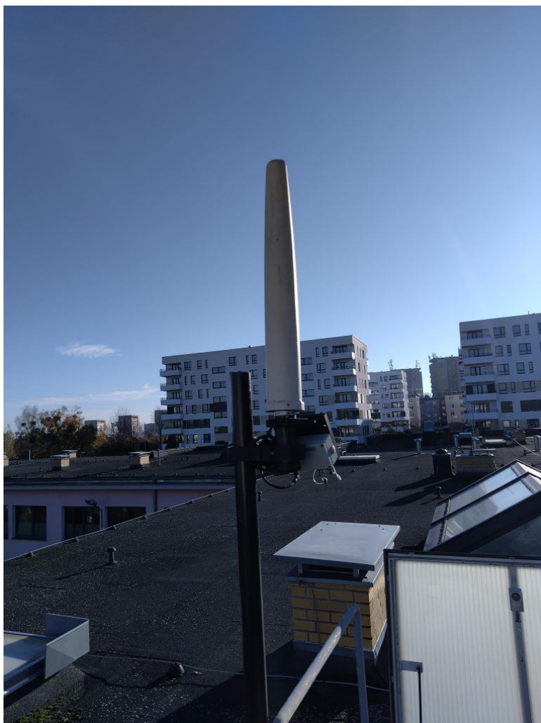
Rys. 3 Widok na SBTk z miejsca montażu SMS PEM – Zakład Wodociągów i Kanalizacji w Szczecinie
