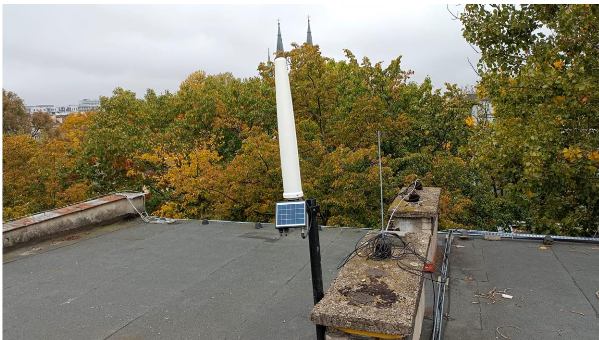
Rys. 3 Miejsce montażu SMS PEM – Urząd Miasta Pruszków
