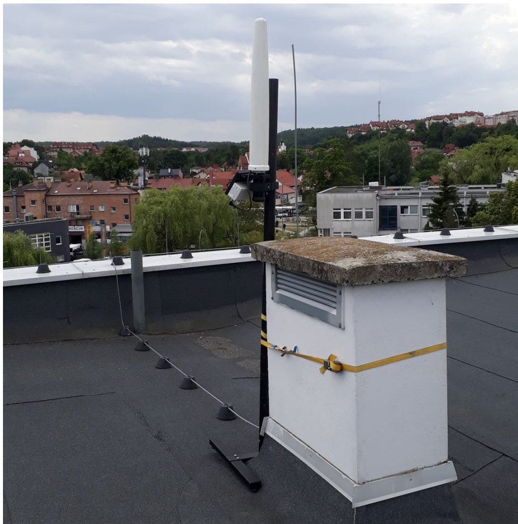
Rys. 3 Miejsce montażu SMS PEM – Zespół Szkolno-Przedszkolny nr 2 w Gdyni – widok na SBTk
