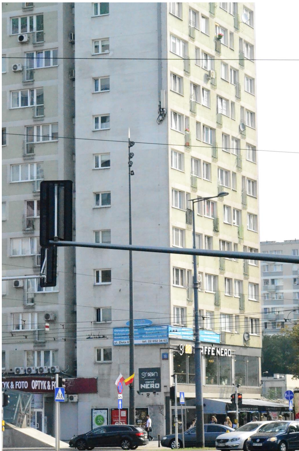
Fot. 1: Widok anteny stacji bazowej ID: BT11100, zlokalizowanej przy Al. Jana Pawła II 18 w Warszawie
