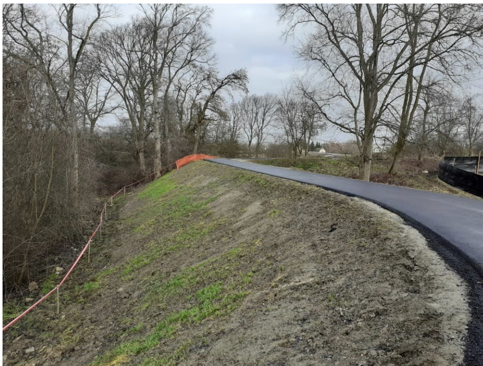
Foto. 24. Zabezpieczenie drzewostanu w granicach Fortu 50a Lasówka (obiekt wpisany do rejestru zabytków) – prawy wał Wisły na odcinku 3.2a, stan w trzeciej dekadzie stycznia 2023 r. (widok w dół rzeki).
