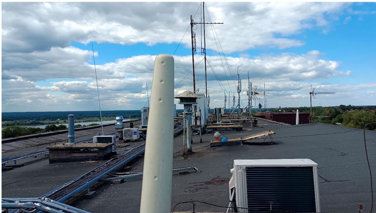
Rys. 4 Miejsce montażu SMS PEM – Wojewódzki Szpital Zespolony w Płocku – widok na SBTk
