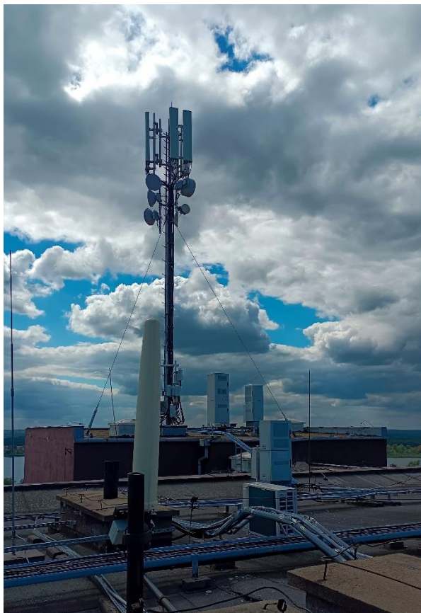
Rys. 3 Miejsce montażu SMS PEM – Wojewódzki Szpital Zespolony w Płocku – widok na SBTk
