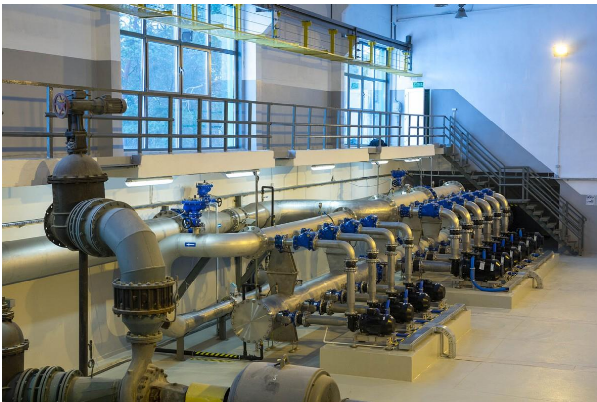
Pompownia przy ul Sulechowskiej w Zielonej Górze
